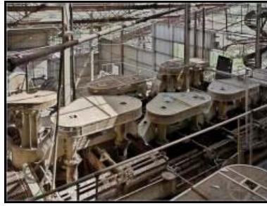
Flotationssystem der Aufbereitungsanlage Santa Lucia, Sardinien Foto: Christian Brünig
